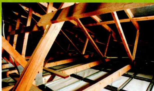
Závěsný strop je neúnosný a je zavěšený táhly. Pod dřevěným vazníkem je volný prostor, který je třeba vyplnit izolací.
