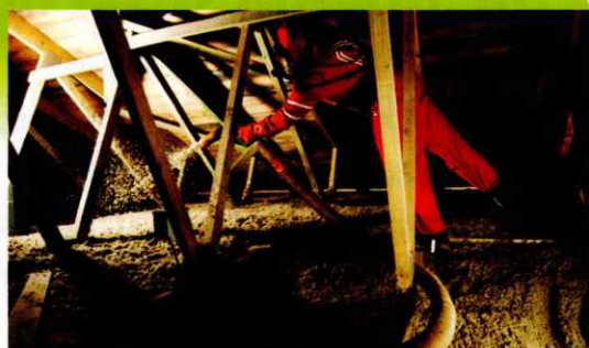
Neúnosný pohled vyžaduje opatrnost. Provedení finální vrstvy a vyrovnání na požadovanou výšku izolace.
